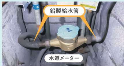
①集合住宅等のパイプスペース内
