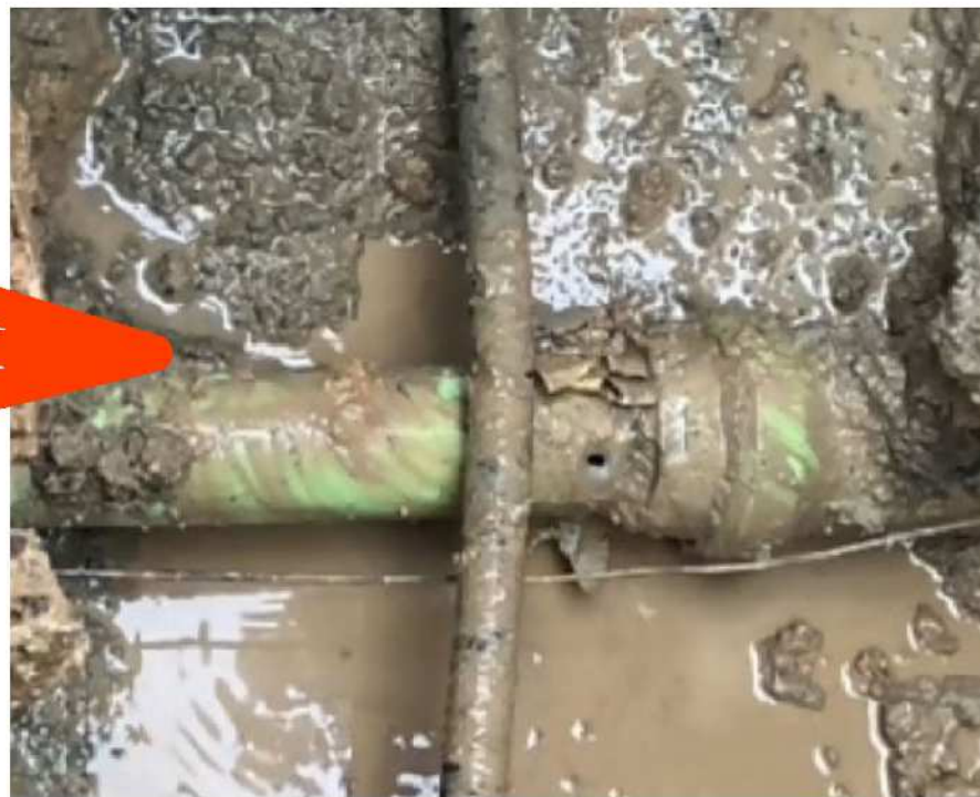
ガス管破損状況
