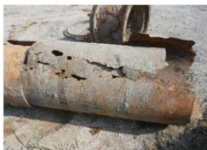
硫化水素により腐食した 下水道管渠（圧送管）
