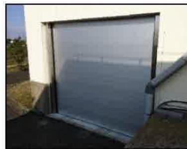
防水扉（防水シャッター）の整備状況
