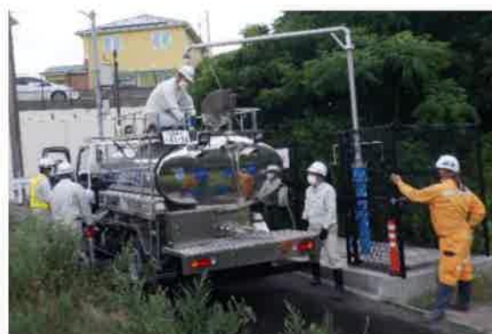
給水塔から給水車への補給状況
