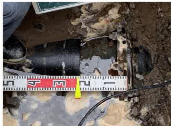
下水道の圧送管の被災
