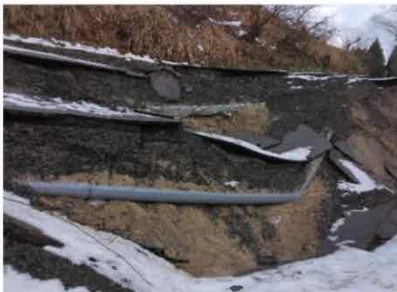
水道の送水管の被災
