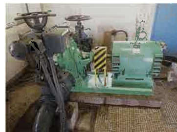
ポンプ設備更新前
