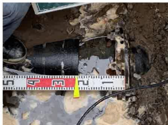
下水道の圧送管の被災
