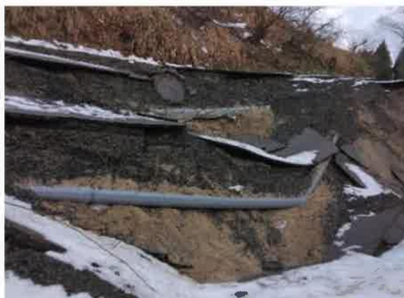
水道の送水管の被災
