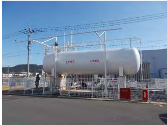
高圧ガス製造施設
