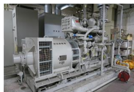
非常用発電装置
