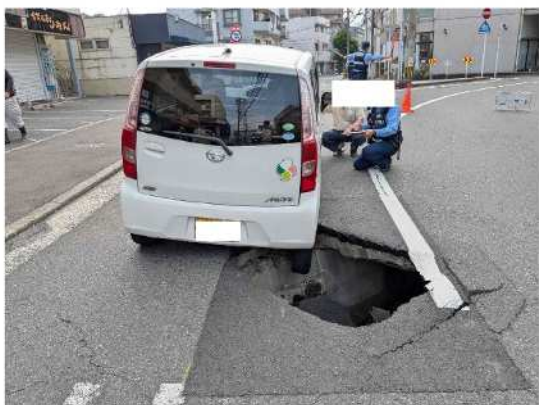
道路陥没直後
