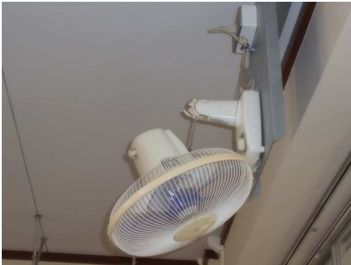
【破損した扇風機】
