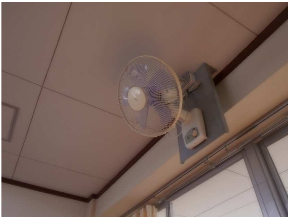
【扇風機設置状況】
