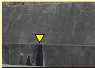
地下水の流出
