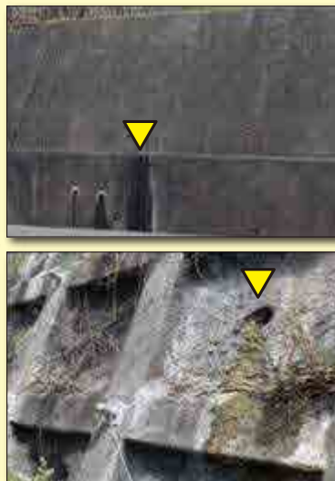
地下水の流出
