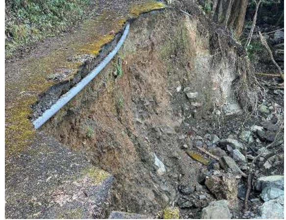
被災状況②
