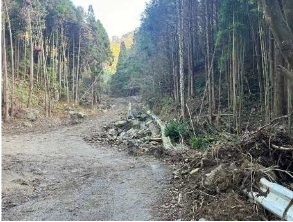
被災状況①
