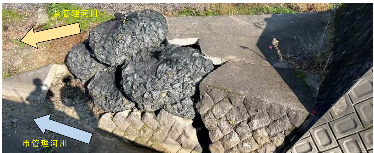
写真－１ 市管理河川と県管理河川との合流部（仮復旧状況）（河災第８号）
