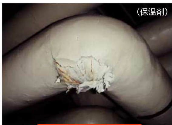
石綿含有断熱材等
