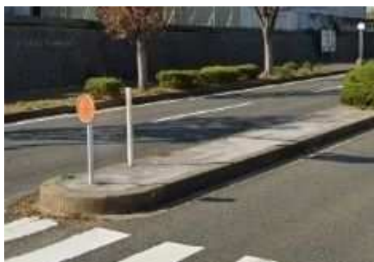
▲中央分離帯の防草対策
