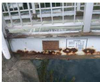
▲ 橋梁の劣化状況
