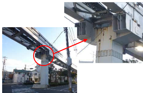
▲ モノレール・鋼製支柱の劣化状況
