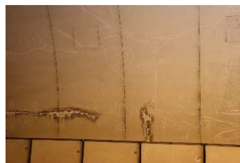
▲ トンネルのひび割れ状況
