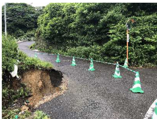
▲ 令和5年7月豪雨災害 (元城町京良城1号線他1線)
