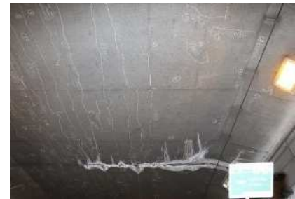
▲ トンネルのひび割れ状況
