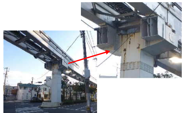
▲ モノレール・鋼製支柱の劣化状況
