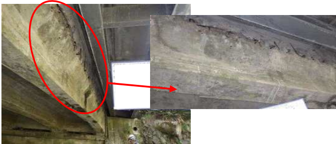
▲ 橋梁のひび割れ状況
