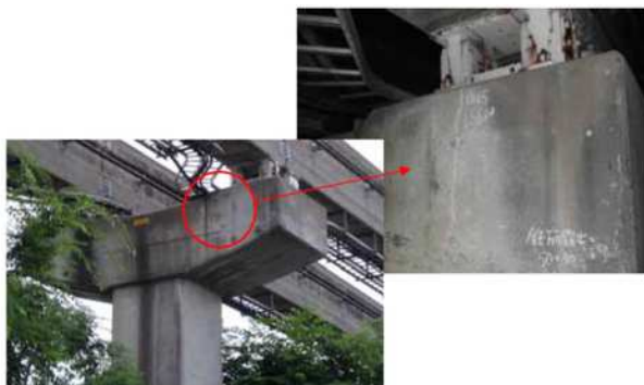
▲ モノレール・RC支柱のひび割れ状況
