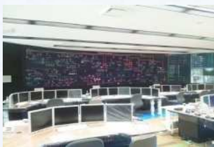
系統給電制御所システム
