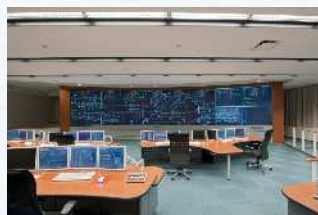
総合制御所システム
