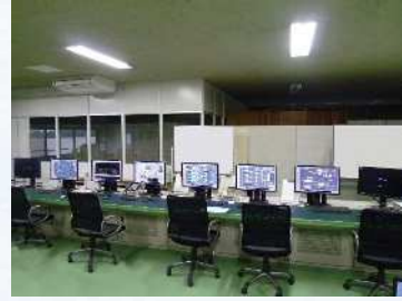
下水処理監視制御システム
