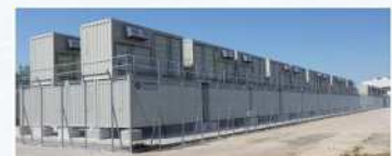
レドックスフロー蓄電システム
