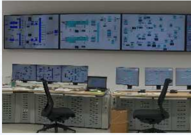
浄水場監視制御システム
