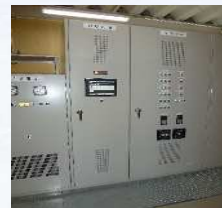
通信機能付照明制御 受変電システム
