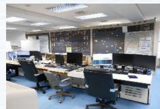
広域型配電線自動制御システム
