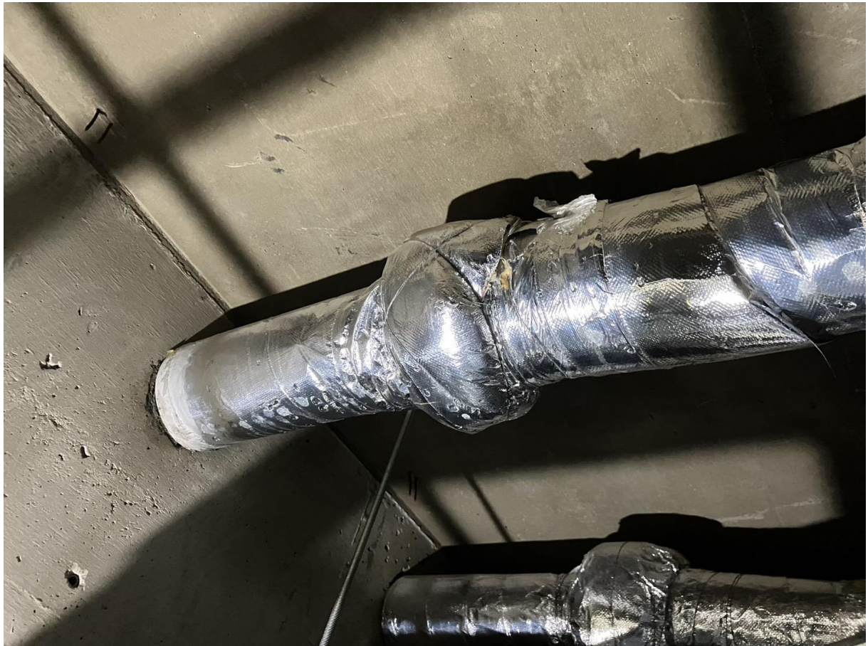
【破損した給水管】
