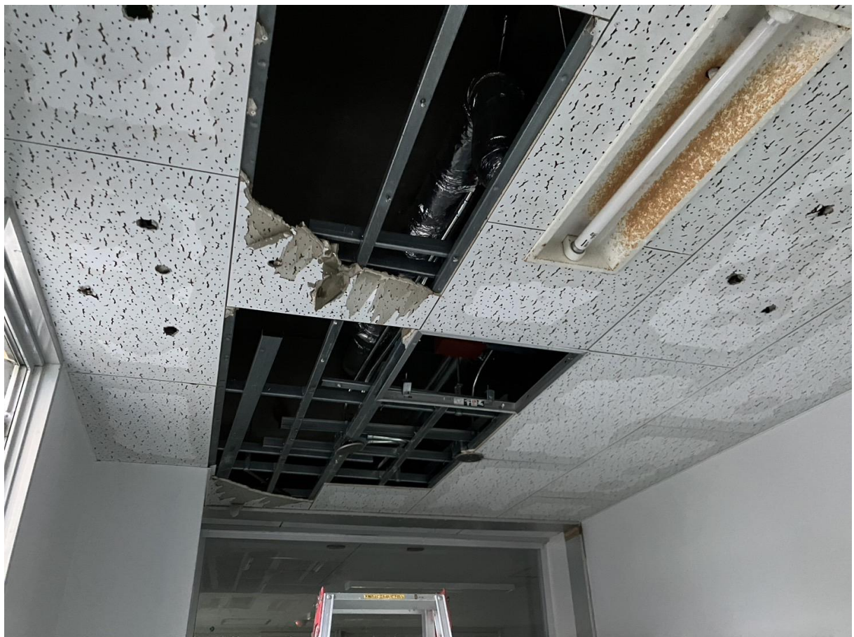
【破損箇所特定のため天井ボードを外した状況】
