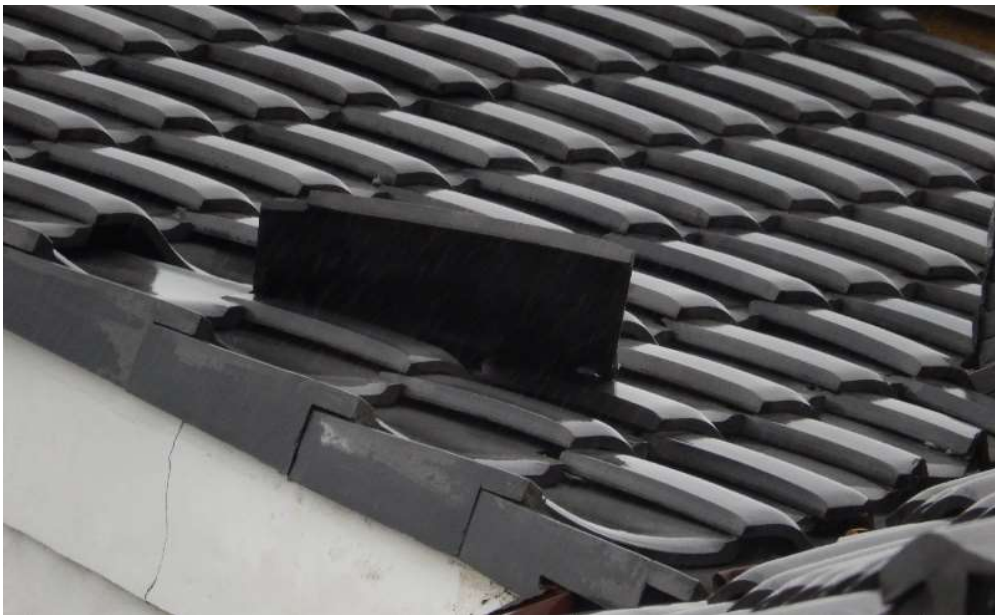
【瓦の剥げかかった箇所】
