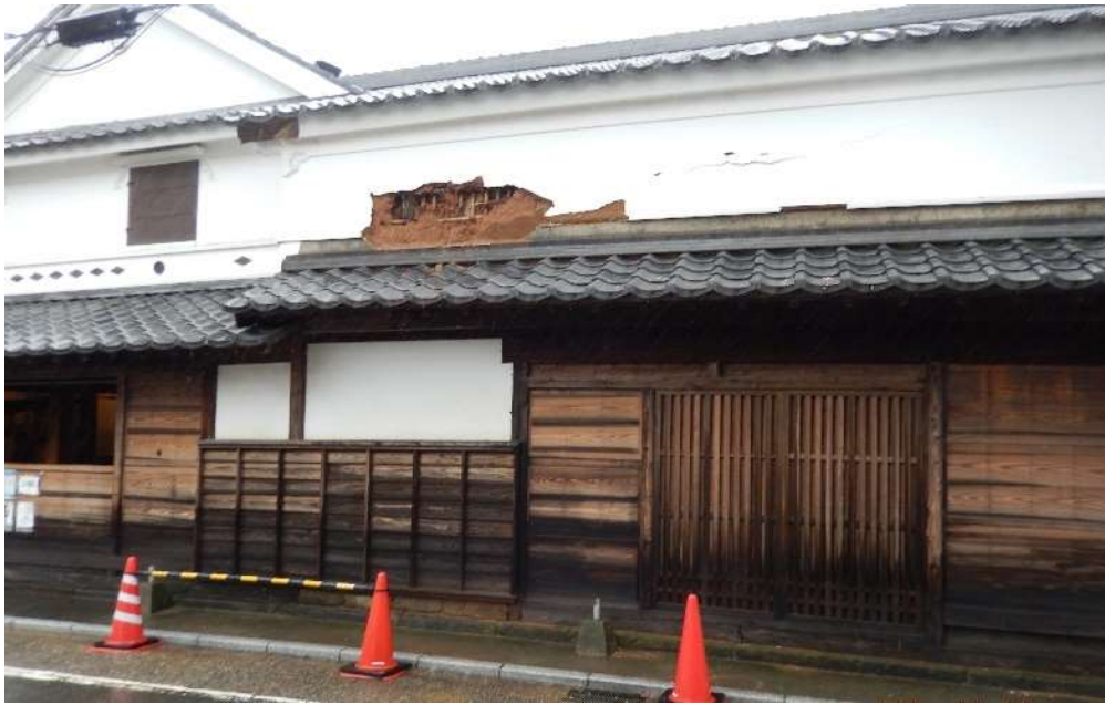
【白壁落下箇所】
