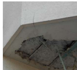
損傷事例 (軒裏の損傷)
