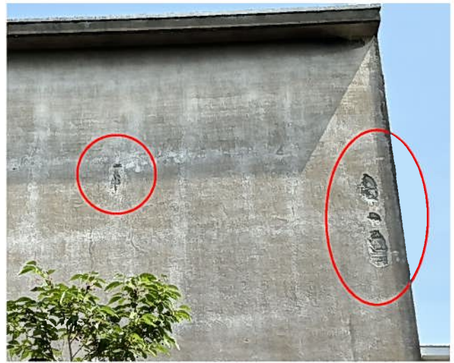
外壁の剥落、鉄筋の露出
