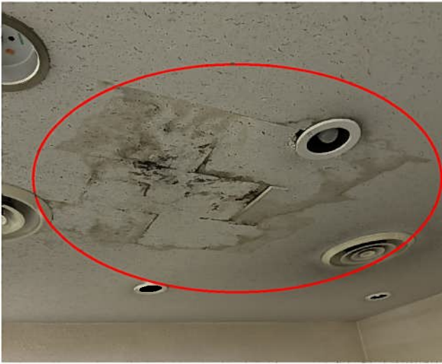
天井の雨漏り
