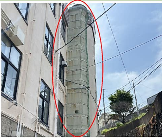
外壁のひび割れ・錆 (剥落防護ネット)
