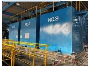
廃油受入タンク
