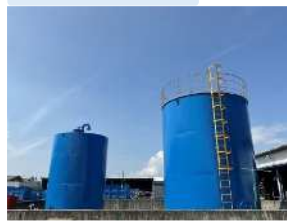
再生重油タンク
