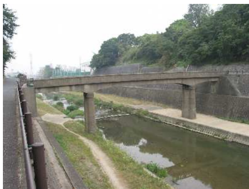
写真 3.2 修繕前の状況
