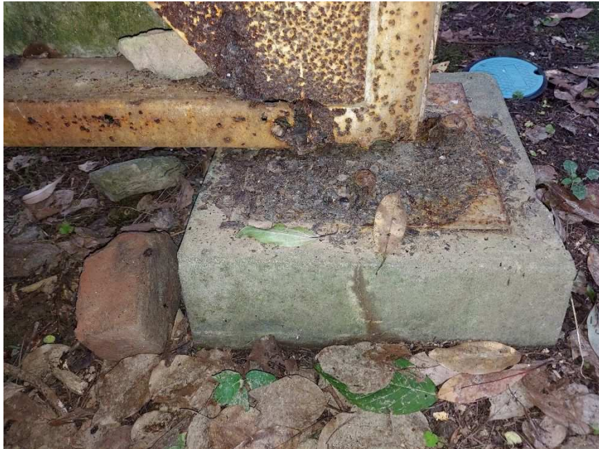
炊事場(屋根付き) 屋根の柱の付け根部分
