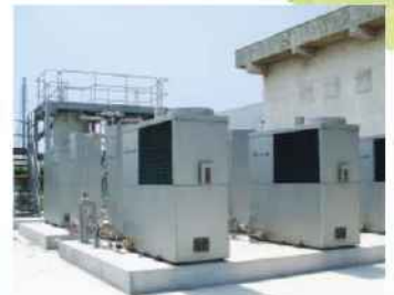
浄化センターの消化ガス発電設備
