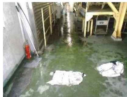
選別室内の雨漏り
