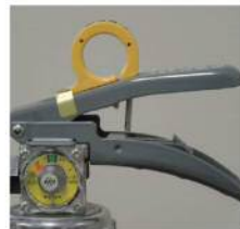
× レバー支えの脱落
