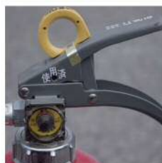
× 表示装置の脱落
