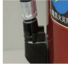
× 消火薬剤の漏れ
