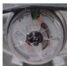
× 指示圧力計の損傷
