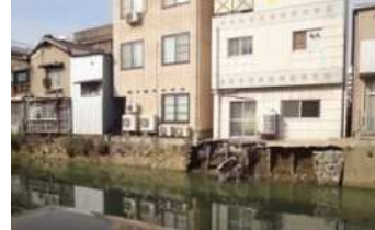
市場対岸側の護岸の崩落 (H26年3月)
