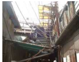
木造建物等の老朽化
