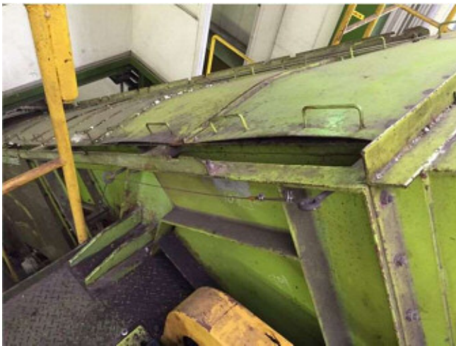
供給コンベア
