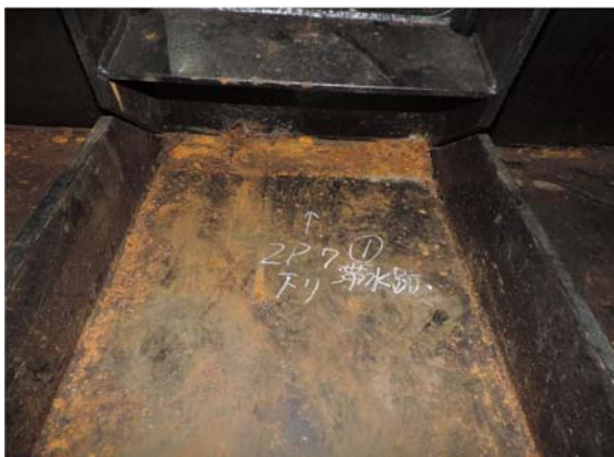
鋼支柱 滞水跡（内面）
