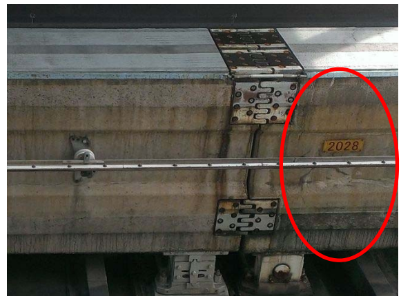
PC 軌道桁 ひび割れ
