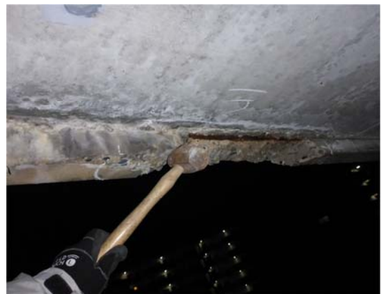
分岐橋 剥離・鉄筋露出（叩落し）
