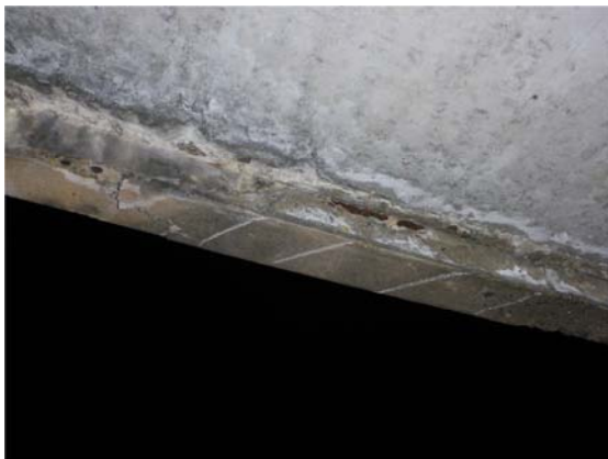
分岐橋 剥離・鉄筋露出
