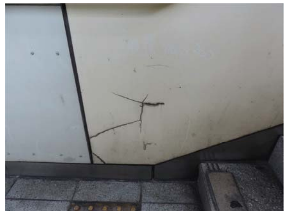
停留場 仕上げ材の破損
