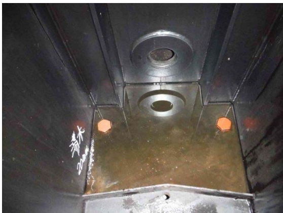
鋼軌道桁 滞水 (内面)
