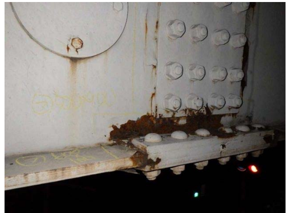
鋼軌道桁 腐食 (外面)
