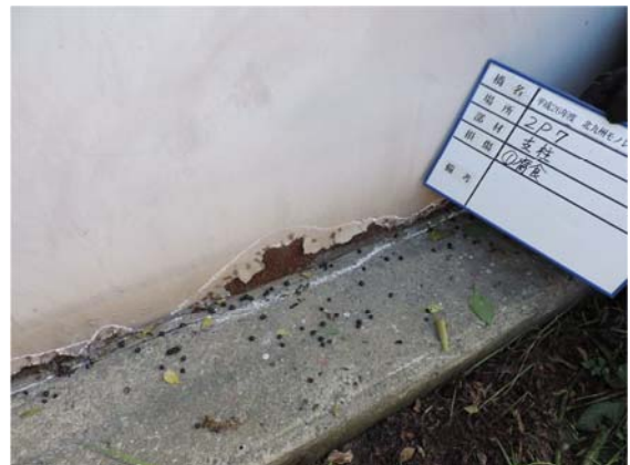
鋼支柱 腐食（外面）
