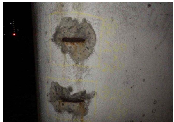
RC 支柱 剥離・鉄筋露出（拡大）
