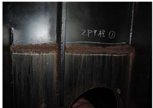
鋼支柱 腐食（内面）
