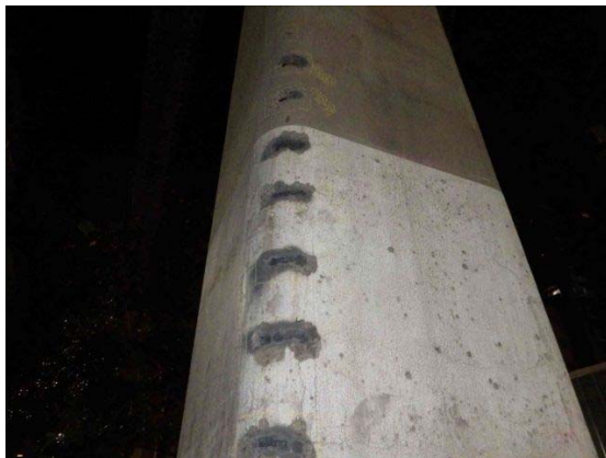
RC 支柱 剥離・鉄筋露出
