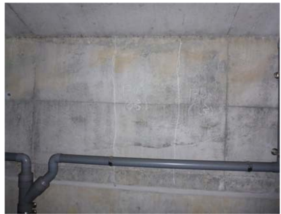
分岐橋 ひび割れ
