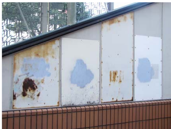
停留場 外板の腐食・破損
