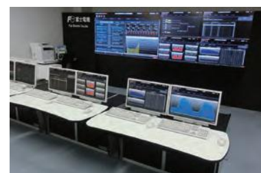
地域節電所内部
