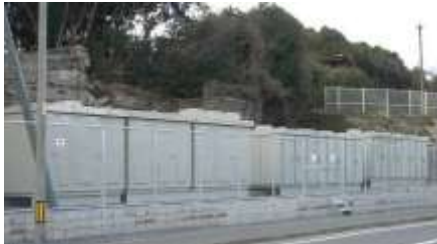
コミュニティ設置型蓄電池 (300kW)
