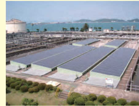
日明浄化センター
