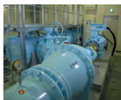
小水力発電 ・穴生発電所 (340kW)
