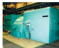
廃棄物発電 ・皇后崎工場 (36,340kW)
