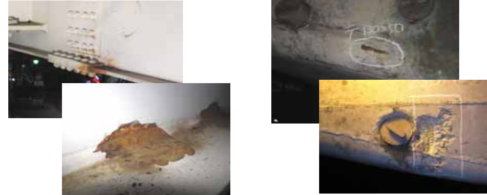
鋼部材の腐食の事例 (鋼軌道桁の主桁)
