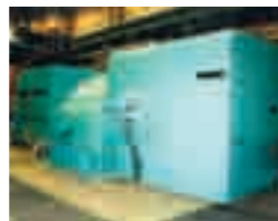
廃棄物発電 ・皇后崎工場(36,300kW)
