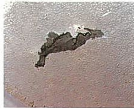
<局部的損傷・欠損>
