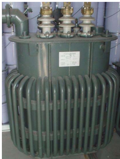
高圧トランス
