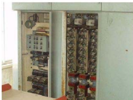
整流器（油循環方式）
