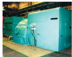
廃棄物発電 ・皇后崎工場 (36,300kw)
