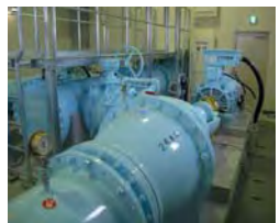
小水力発電 ・穴生発電所 (340kw)
