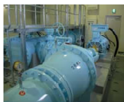
小水力発電 ・穴生発電所 (340kw)
