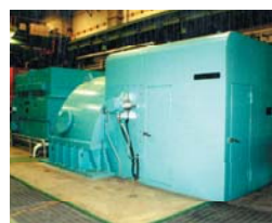
廃棄物発電 ・皇后崎工場 (36,300kw)
