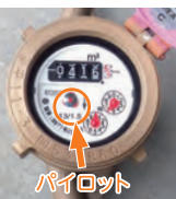
▲水道メーター
