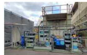
パイロットプラント実証設備
