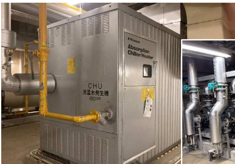
冷温水発生器(空調設備)
