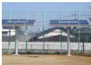
太陽光発電設備（出力3kWの設置例）
