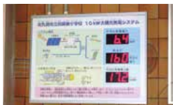
電力モニター
