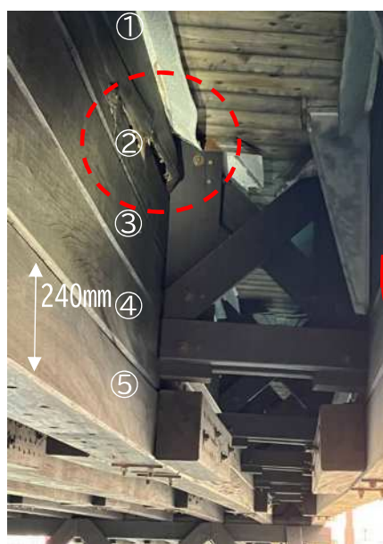
損傷状況(上流側左岸)
