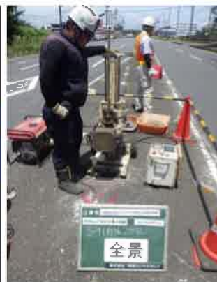
貫入試験による空洞調査
