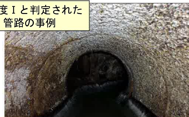
管の腐食から緊急度Ⅰと判定
