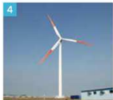
4 陸上風力 電源開発(株) 発電能力：2,700kW 基数：1
