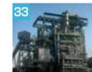
33 蒸気の企業間連携 (CDQ発電) 日本コークス工業(株)北九州事業所 発電能力：44,400kW
