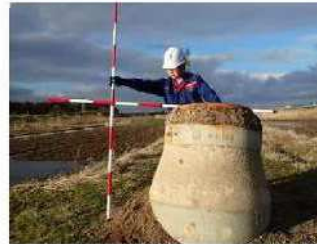
マンホール浮上現場（中能登町）
