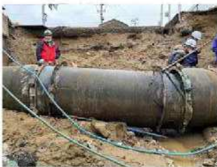
送水管の被害（七尾市）
