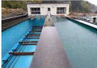
浄水場の被害（珠洲市）
